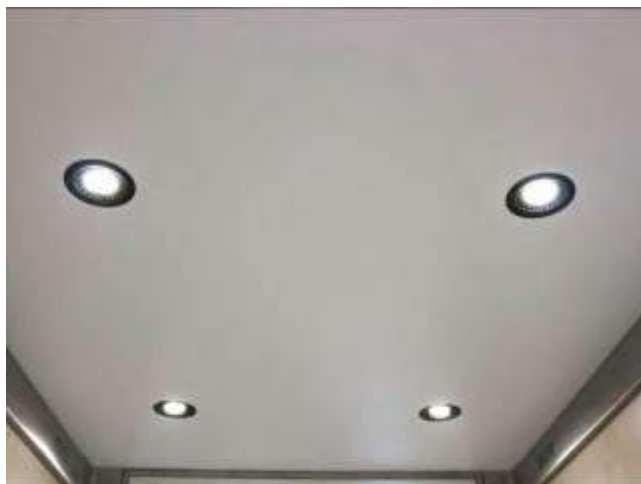
Esempio di cabina con nuovo cielino / Example of cabin lift with new ceiling
